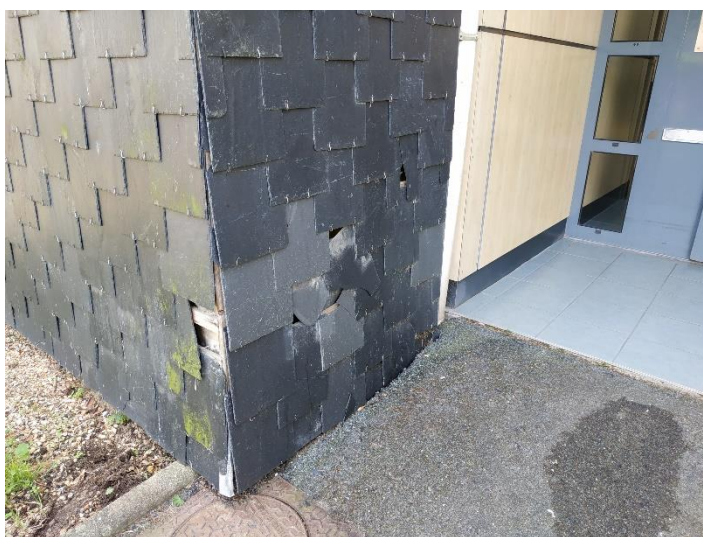
FIGURE 5 : ARDOISES CASSEES ET OU MANQUANTES.
